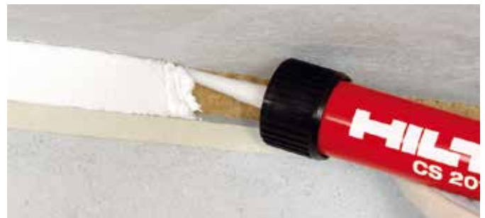
③ Fuge Wand zur Decke.
