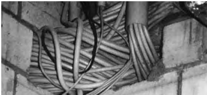
Abschottung mit mehr als 60% Belegung ist nicht zulässig.
